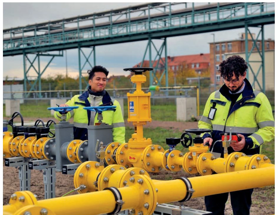
Das Wasserstoff-Dorf in Bitterfeld-Wolfen umfasst Leitungen, Pumpen und Automatisierungstechnik.
